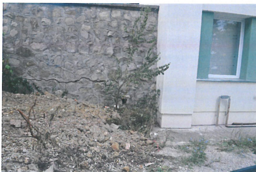
Foto nr. 6 – Aspect fisură orizontală zid de sprijin
