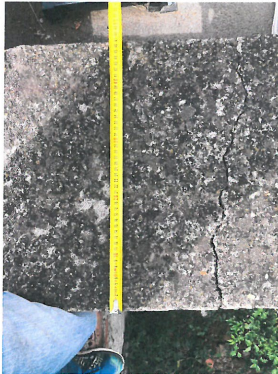
Foto nr. 4 – Aspect fisură la partea superioară a zidului de sprijin
