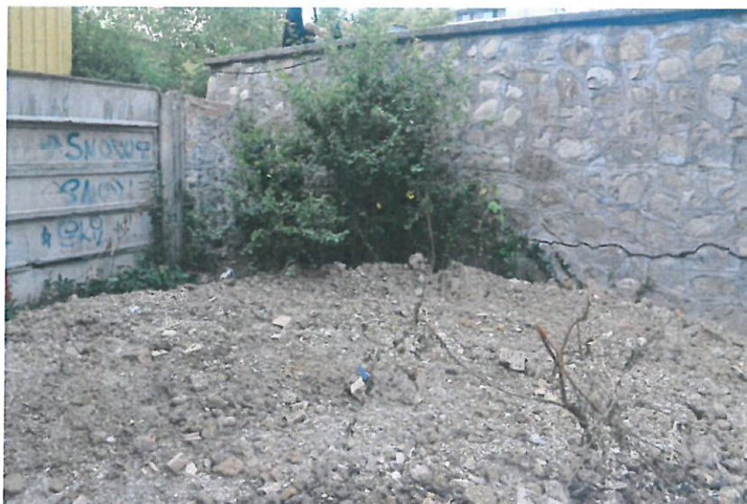
Foto nr. 5 – Aspect fisură orizontală zid de sprijin
