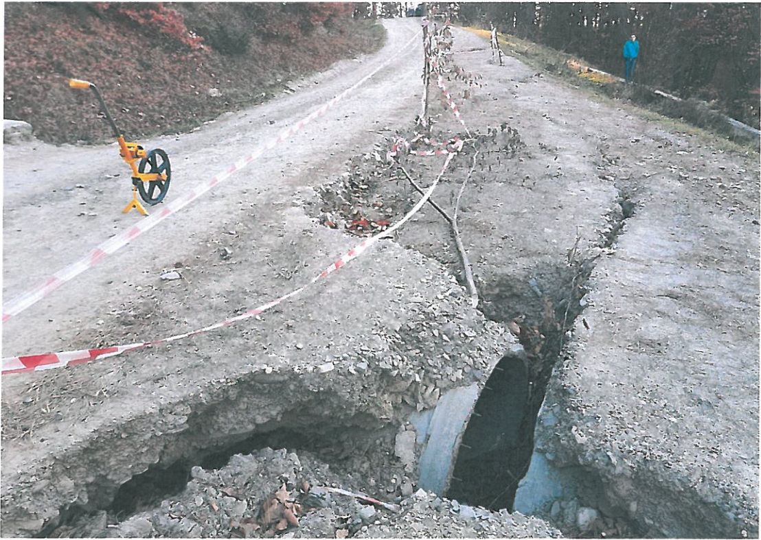
Foto 3: Vedere desprindere tuburi podet pe zona alunecarii de teren
