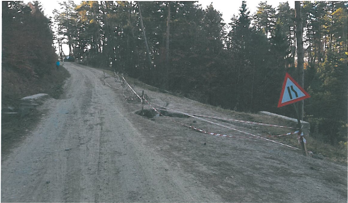
Foto 1: Vedere zona alunecare km 10+800
